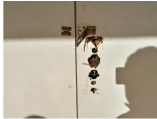
llavín desprendido comedor
