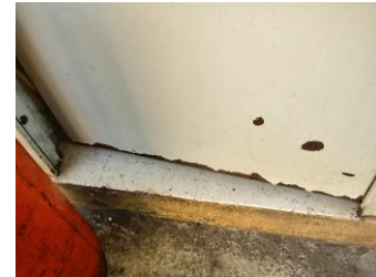
manija del llavín desprendido y cerradura, comedor
