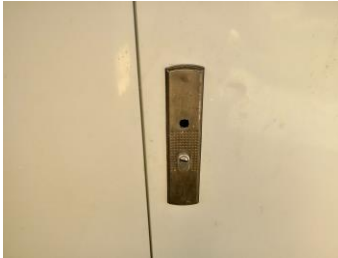
tola oxidada puerta cocina
