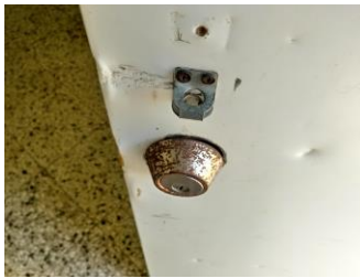
Llavín oxidado puerta aula
