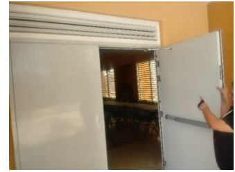
aquí la el cierre de arriba esta mal funciona
